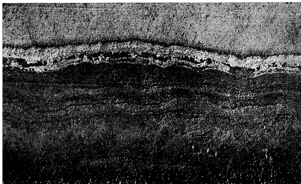
Fig. 33. Brømmer af \text{Na}_2\text{S}_04 paa en Betonsokkels Puds, Naar Vandet er steget saa højt, at det er blevet overmættet, udskiller Saltene sig.
