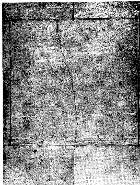
Fig. 103. Revnet Beklædningsplade af Savonniere i Politigaardens aabne Forhal mod Politortorvet i København. Revnen skyldes formentlig Pladens Sammentrækning i Frostvejr.
